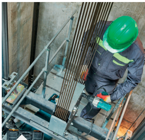
Ascensores y equipos de elevación.
